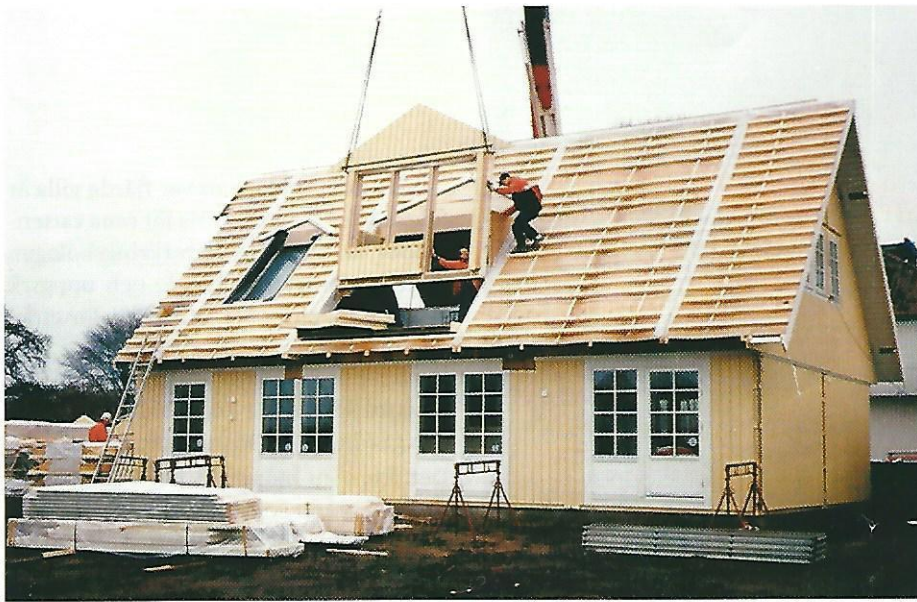
Figur 3.1 1/2-planshus förtillverkat som två volymelement och yttertak med mera som storblock. Foto: Christer Harrysson
